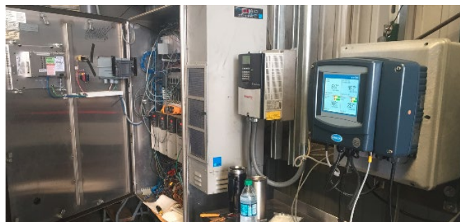
Rysunek 1: Zainstalowany moduł optymalizacji zagęszczania osadu w czasie rzeczywistym (RTC-ST) firmy Hach pomaga monitorować i dopasowywać oczyszczanie chemiczne, poziom pH i przepływ w podczyszczalni zakładu mleczarskiego.
