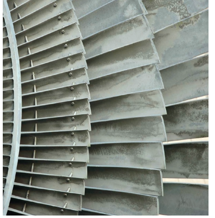
Türbin kanatları üzerinde silis birikmesi çok önemli bir sorundur
