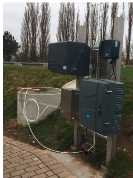
Zdjęcie 2: Analizator azotu amonowego Hach Amtax sc, sonda azotu amonowego Nitratax sc i moduł SC1000.
