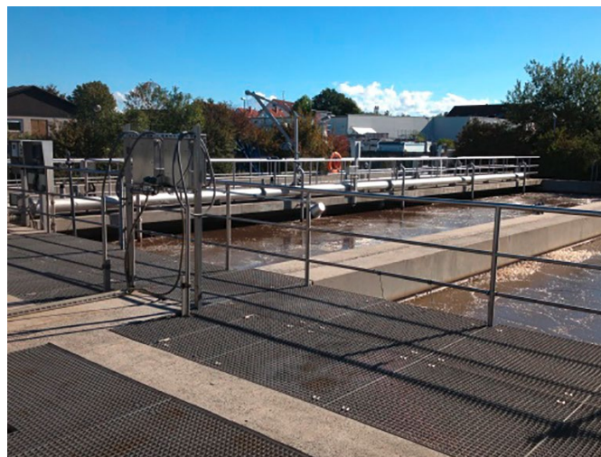
Lay-out met twee bassins van de afvalwaterzuiveringsinstallatie
