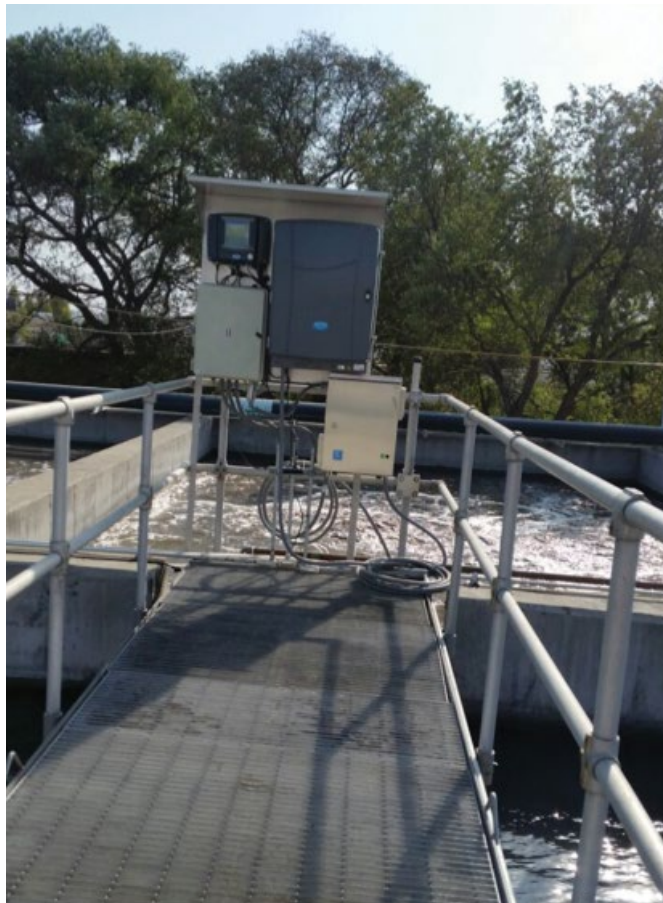
Fig. 7. Sistema RTC-P installato e in funzione
