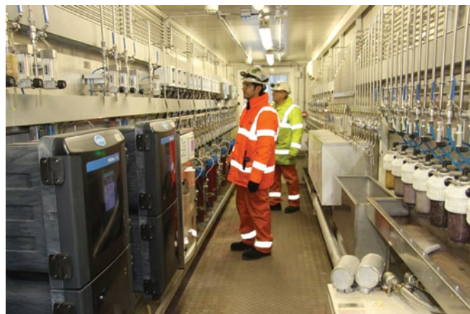
Provoz analyzátorů kotelní vody
