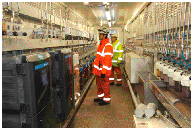
"Casa" do analisador de caldeira
