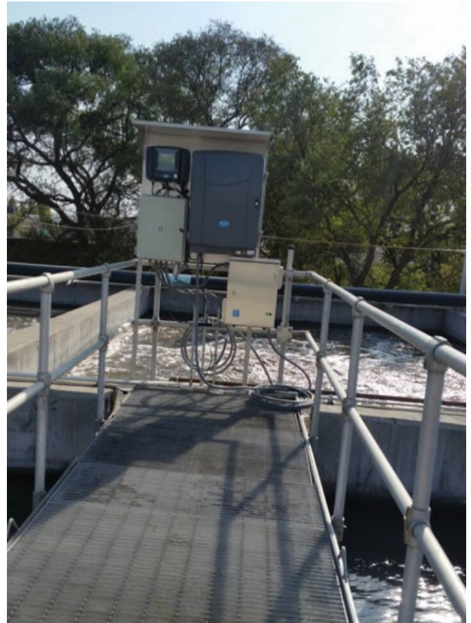
Abbildung 7: Installiertes und arbeitendes RTC-P-System
