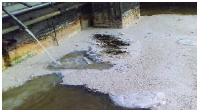
Rys. 1. Analizator BioTector monitoruje OWO w tym zbiorniku ścieków mleczarskich od 1997 roku; jego czas pracy przekracza 99,7 %
