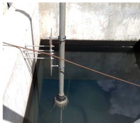
Датчик SONATAX sc над бункерным накопителем осадка.
