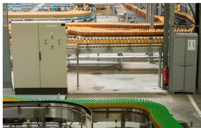
Bottelingslijnen in de installatie
