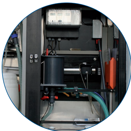
Fig. 1: Sonda per nitrati NITRATAX plus sc (bypass), installata nel vano dell'autocampionatore.
