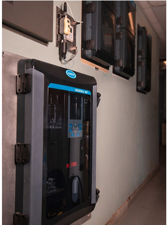
Fig. 2: El analizador de sodio NA5600sc de Hach
