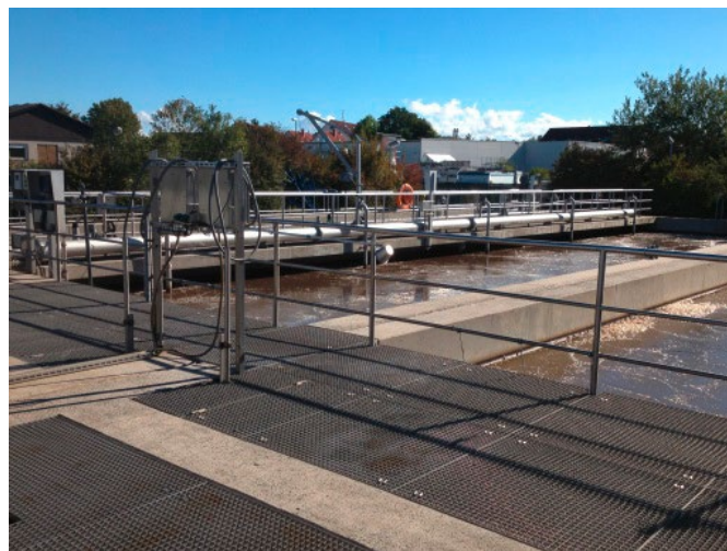
Deux files de traitement sur la station d'épuration
