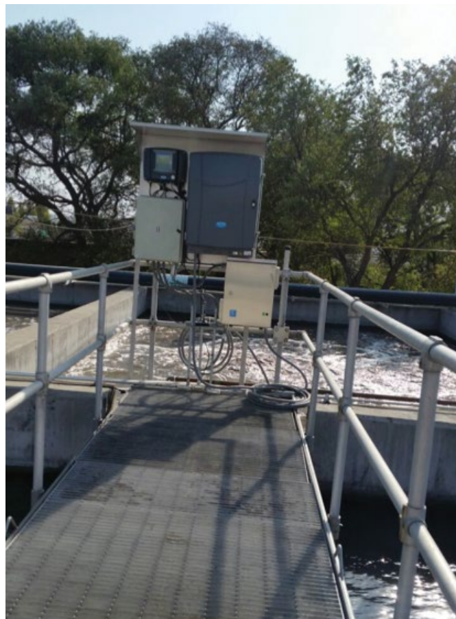
Rys. 7. Zainstalowany i uruchomiony moduł RTC-P
