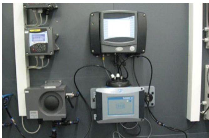
Rysunek 3: instalacja TU5400 wraz z SC1000 w stacji uzdatniania wody w Niemczech
