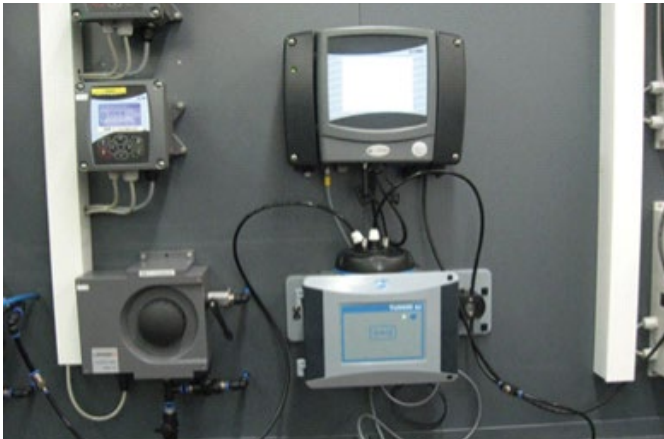
Figur 3: TU5400 proces-turbidimeter med SC1000 kontrolenhed på et tysk vandværk
