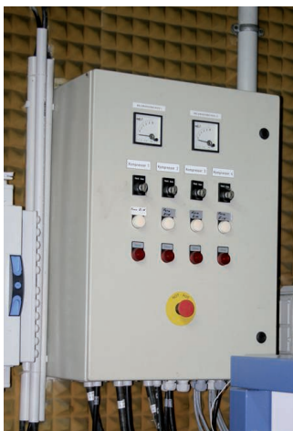
Afbeelding 1: „De RTC module is eenvoudig te integreren in bestaande regelsystemen voor installaties.”
